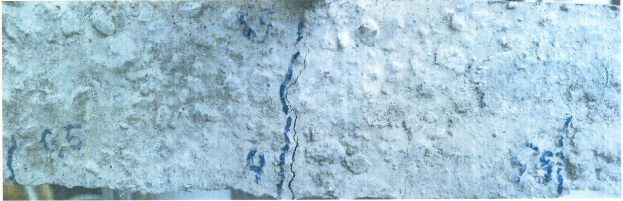
Рисунок 1. Балка №1 - образование трещин.
